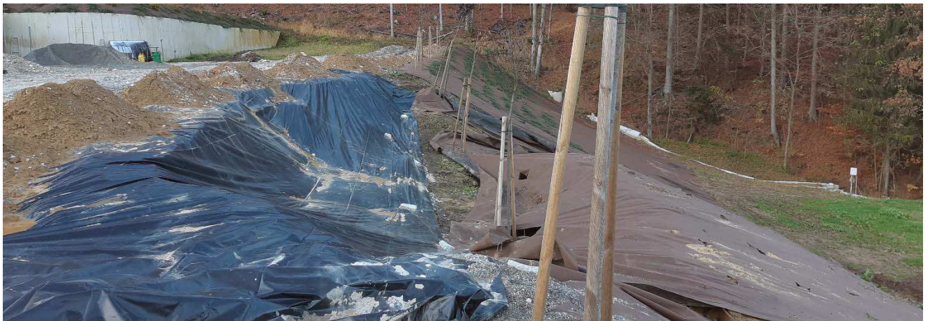
Slika 3: Porušitev izvedenega nasipa.
