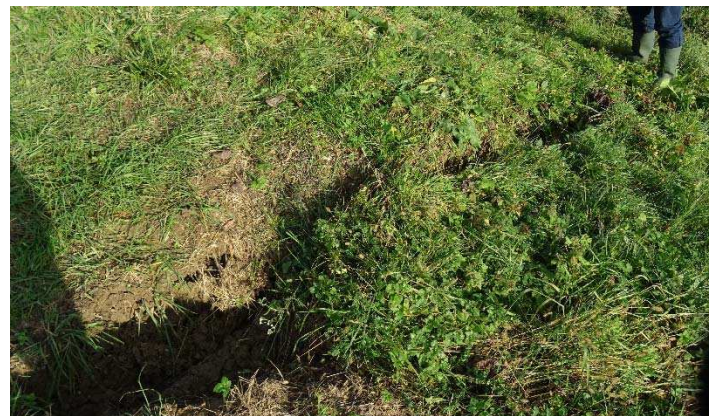
Slika 5: Razpoke na površju na brežini pod nasipom.
