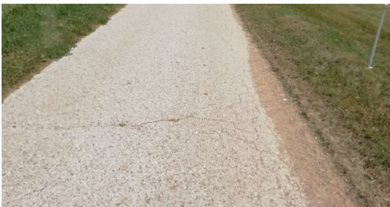
Slika 9: Razpoke in manjši posedki na cesti LC 372061
