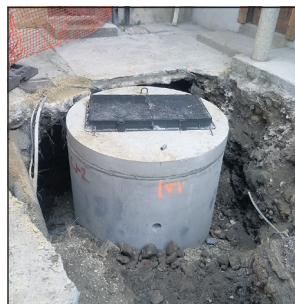
Črpališče v NHM v Sevnici
